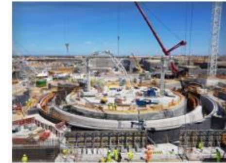
Fin 2027 : 1 er béton de l'îlot nucléaire J0 unité n°1 (2029 pour l'unité n°2)
